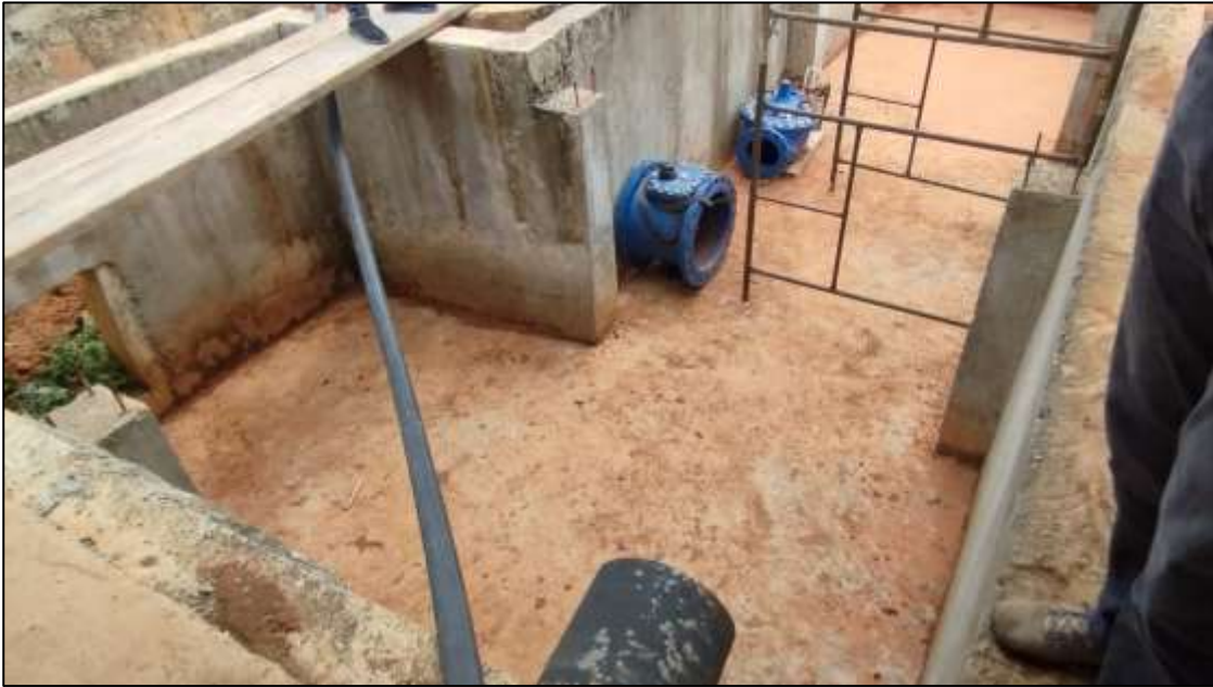
Cámara que conectara las bombas con la tubería de conducción a la entrada de la PTAP
