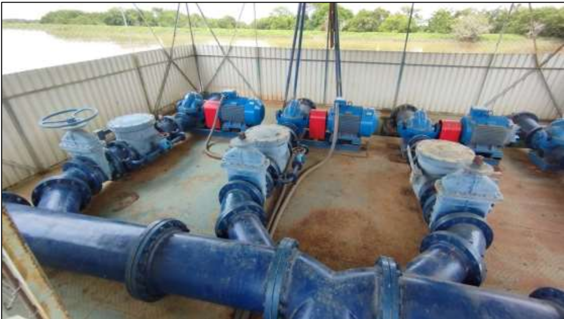
Imagen de las bombas principales y las de repuesto que están en la barcaza
