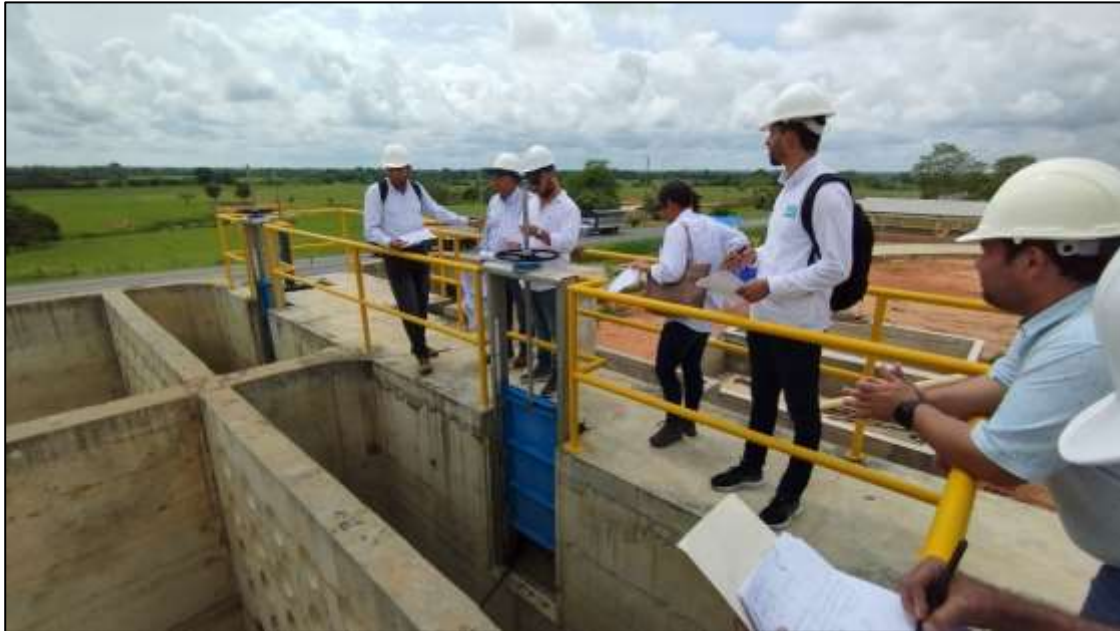
Comisión técnica verificando que la red hidráulica de la planta esta completa
