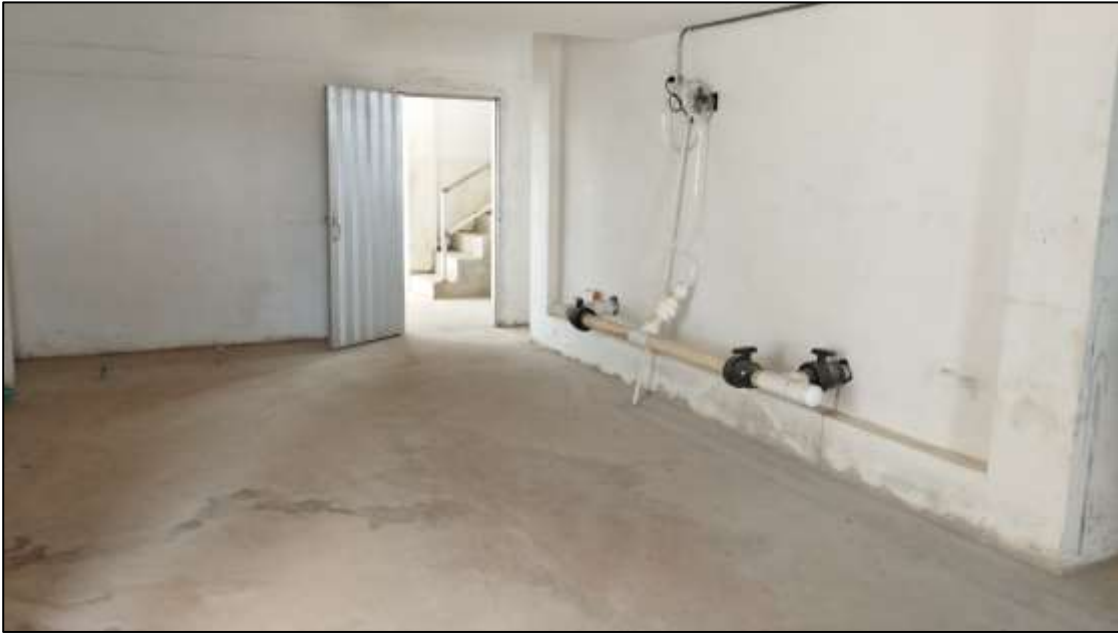
Instalación del equipo distribuidor del coagulante hacia los tanques mezcladores
