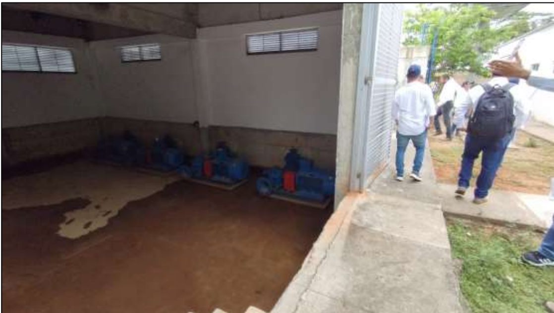
Interior de la estación de bombeo de buena Vista hacia Planeta Rica con las bombas instaladas
