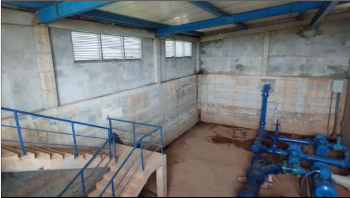
Interior de la estación de bombeo en la PTAP
