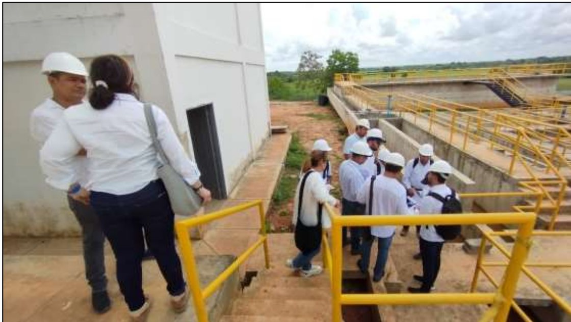
Comisión técnica revisando en planos lo ejecutado. Las únicas 2 personas sin casco son la gerente de Aguas de Córdoba (izq) y en el centro bajo la escalera la directora jurídica de la misma entidad
