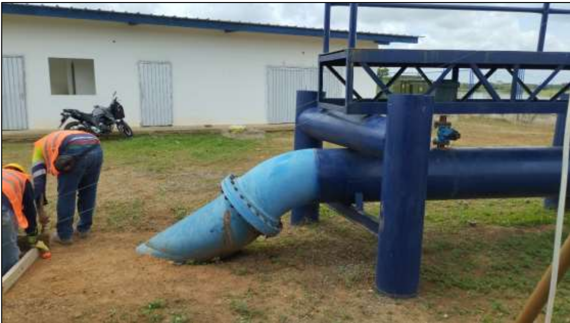
Red de conducción que sale de la captación hacia la planta para ser distribuida a los municipios
