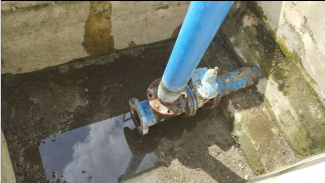
Brida y válvula del tanque de almacenamiento en Planeta Rica donde la cámara ejecutada no es contractual y no se puede colocar tapa a este elemento.
