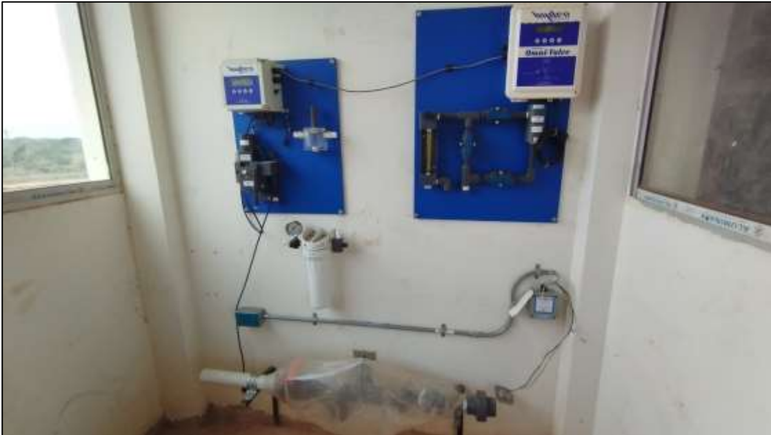
Dosificadores electrónicos para desinfección ya instalados
