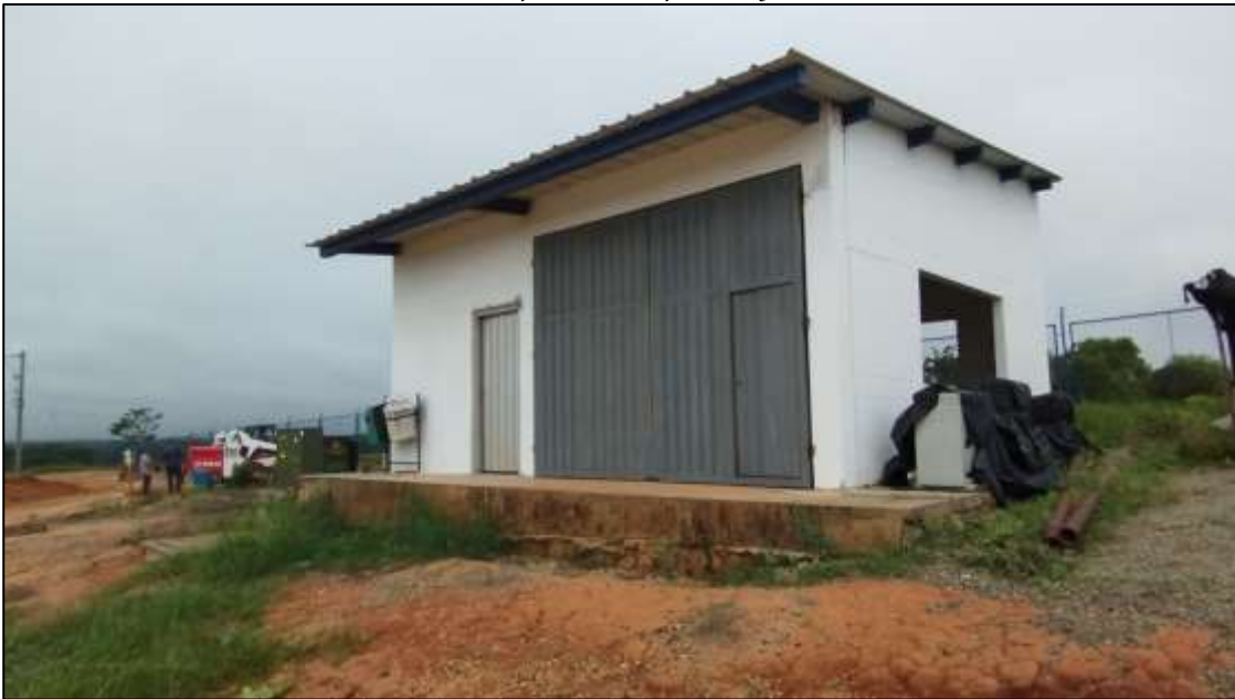
Cuarto eléctrico con Portón principal instalado
