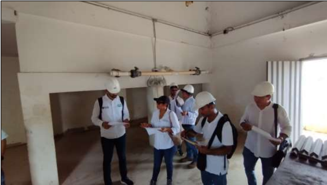
Equipo técnico junto a uno de los equipos distribuidores del coagulante
