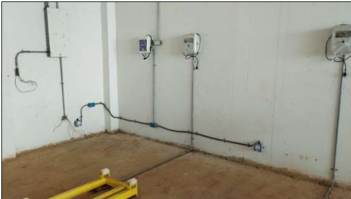
Pedestales y tableros para los tanques de desinfección
