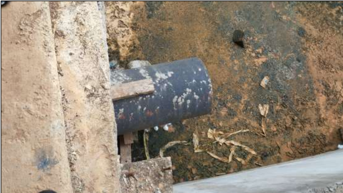
Conexión faltante al interior de la cámara que se está construyendo de la red que va hacia Buena Vista
