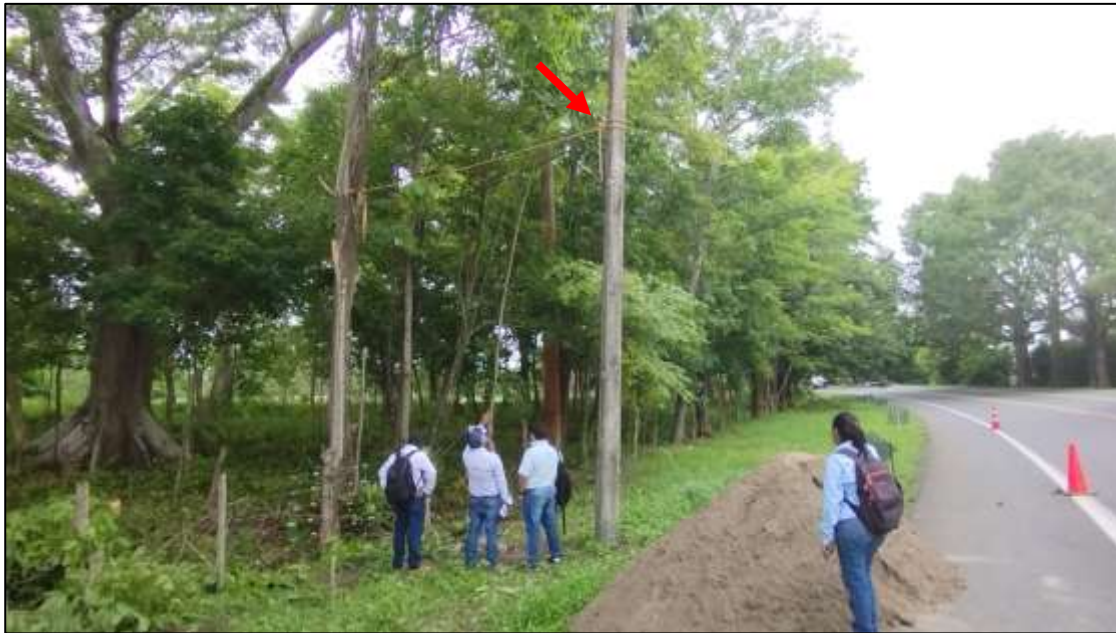
Poste a punto de caer sobre la vía, sostenido con una cuerda a un árbol cercano
