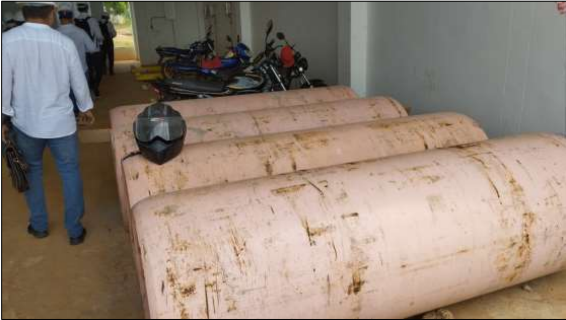
Tanques de desinfección a la entrada del edificio, al fondo se ven los tableros donde deben instalarse
