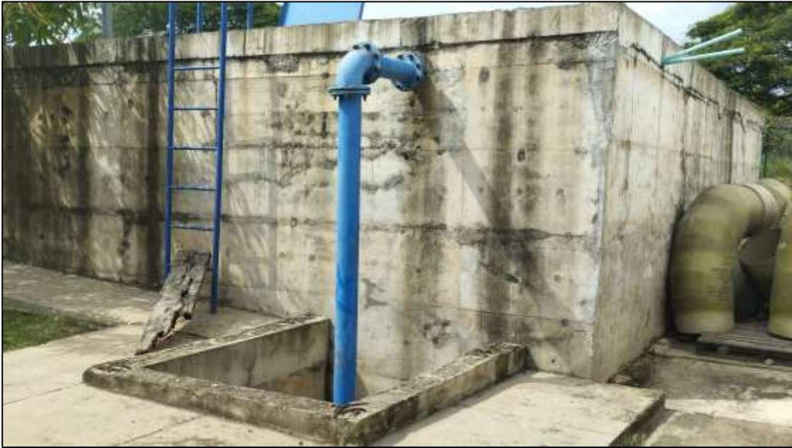
Brida y válvula del tanque de almacenamiento en Planeta Rica donde la cámara ejecutada no es contractual y no se puede colocar tapa a este elemento.
