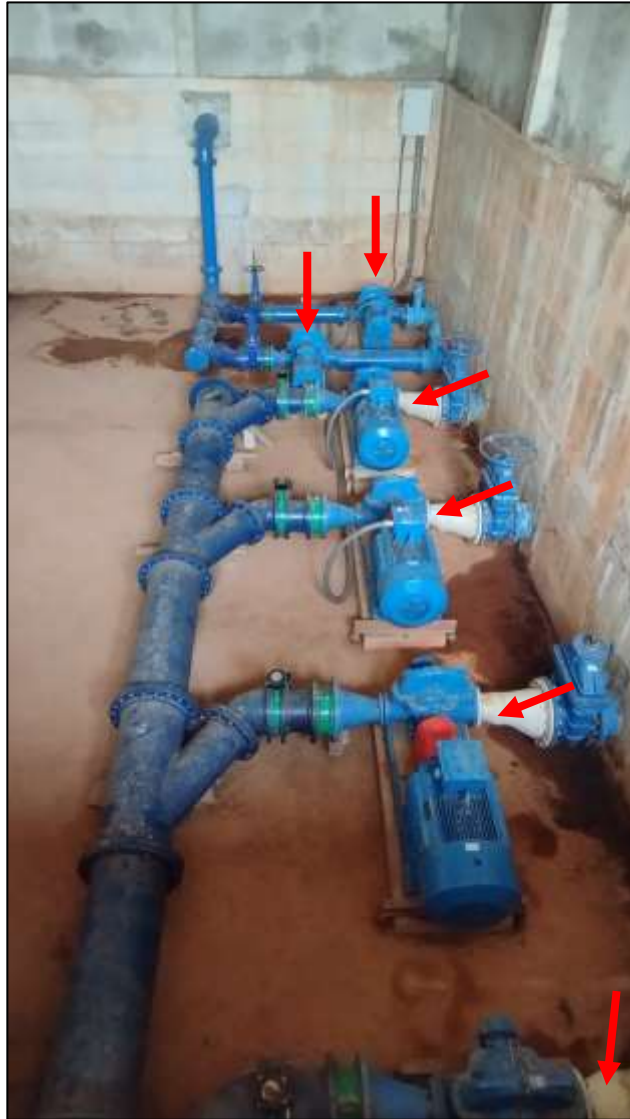
Equipo de bombeo de las dos estaciones que están en simultanea dentro de la PTAP, se ven al fondo las 2 bombas de la E.B. La Apartada y mas cerca las 4 bombas de la E.B. Buena Vista
