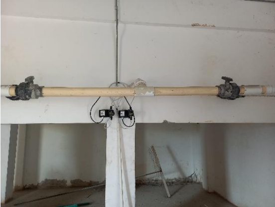
Sistema de bombeo de coagulantes
