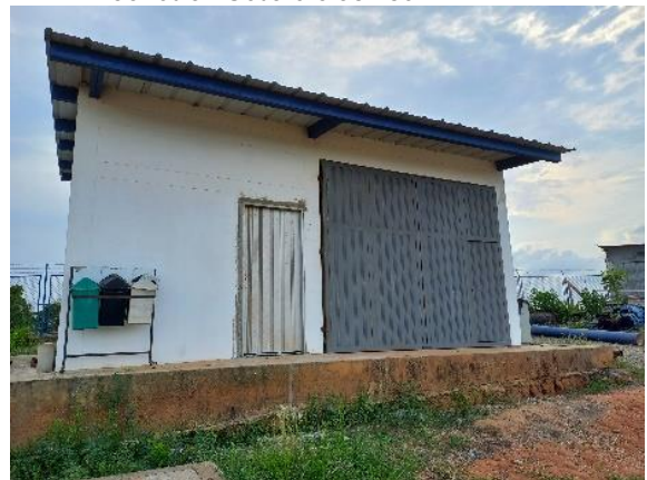
Puertas en Caseta eléctrica
