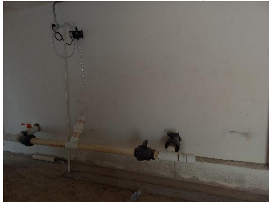
Sistema de bombeo de coagulantes
